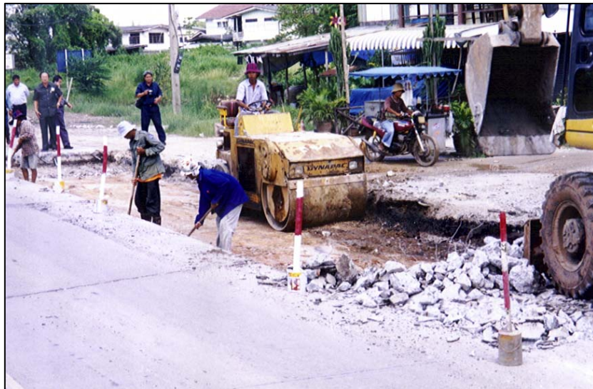
รูปที่ 3.7.4 บดอัดพื้นที่ก่อนที่จะทำการซ่อมแซม
