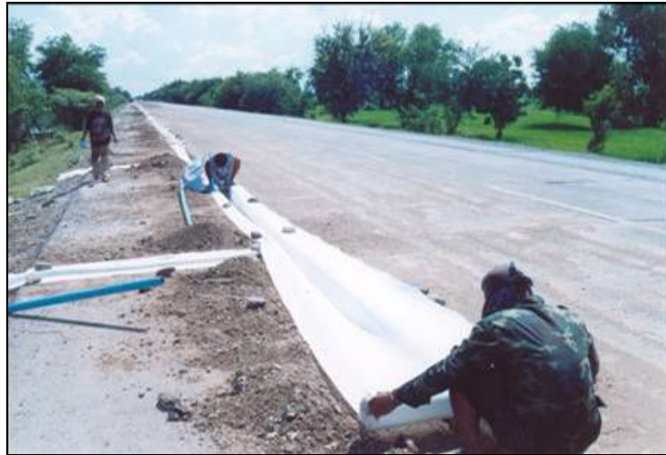
รูปที่ 5 ปูแผ่น Geotextile และวางท่อ PVC
