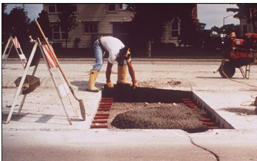
รูปที่ 3.7.6 เทคอนกรีตลงในพื้นที่ที่เตรียมไว้
