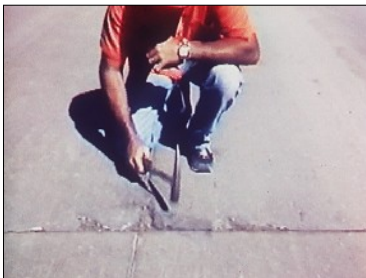
รูปที่ 3.5.1 ตรวจสอบความเสียหายของคอนกรีต
