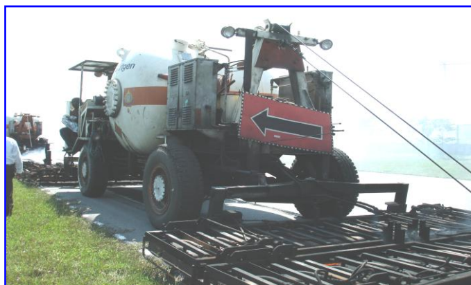
รูปที่ 8 เครื่อง Pre-heater
