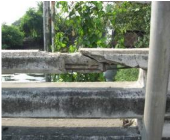
รูปที่ 4-83 สังกะสีกร่อนจนเห็นเหล็กเสริม
