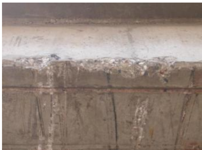
รูปที่ 4-8 การเสียหายจากการถูกชนของพื้นด้านล่าง
