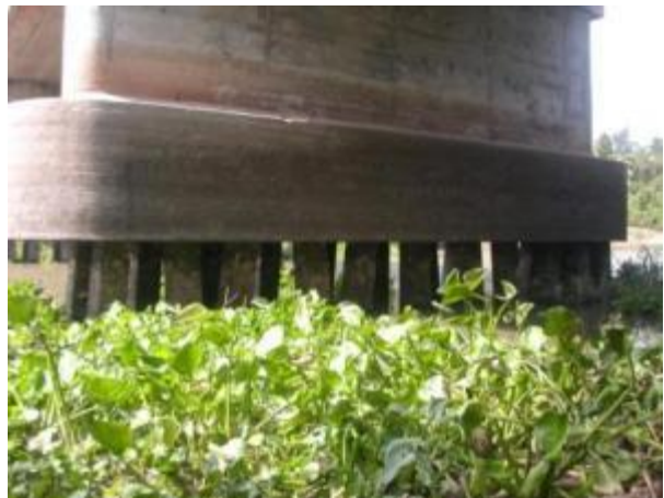
รูปที่ 4-41 แสดงการกัดเซาะบริเวณท้องน้ำ
