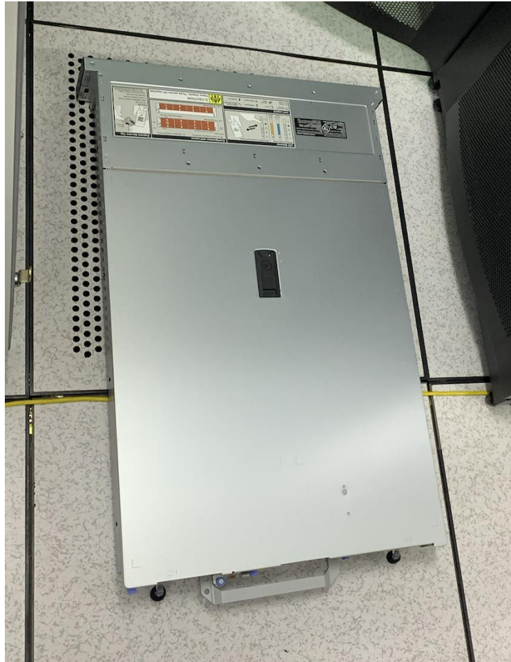
รูปที่ 2-202 ภาพอุปกรณ์เครื่องแม่ข่าย พร้อมดำเนินการติดตั้ง
