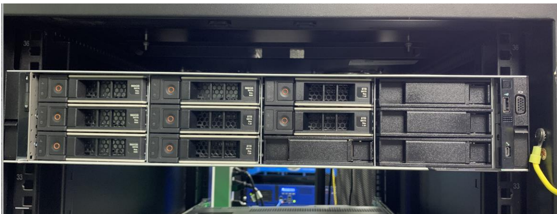
รูปที่ 2-203 ภาพอุปกรณ์เครื่องแม่ข่ายหลังดำเนินการติดตั้ง
