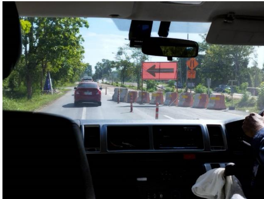
ทางหลวงหมายเลข 4 ตอนควบคุม 1302 กม. 1167+600 - 1166+800 แขวงทางหลวงพัทลุง ตัวอย่างลักษณะปัญหา : งานก่อสร้าง
