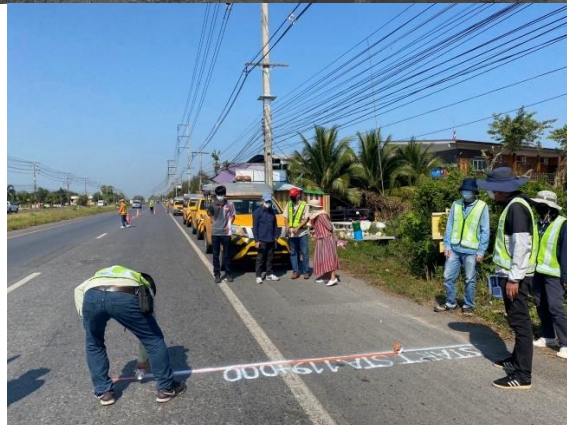
รูปที่ 4-44 พื้นที่ทดสอบอุปกรณ์ ทางหลวงหมายเลข 33 ตอน 501 ผิวทางลาดยาง ที่มีความเสียหายของผิวทางค่อนข้างมาก
