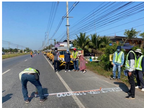
รูปที่ 3-44 พื้นที่ทดสอบอุปกรณ์ ทางหลวงหมายเลข 33 ตอน 501 ฝิวทางลาดยาง ที่มีความเสียหายของฝิวทางค่อนข้างมาก
