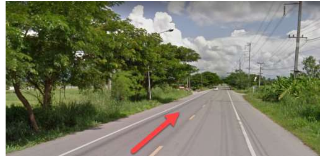
รูปที่ 7 ทิศทางการสำรวจช่องจราจรด้านซ้ายสุดของถนนในทิศทางที่มีความเสียหายมากที่สุด
