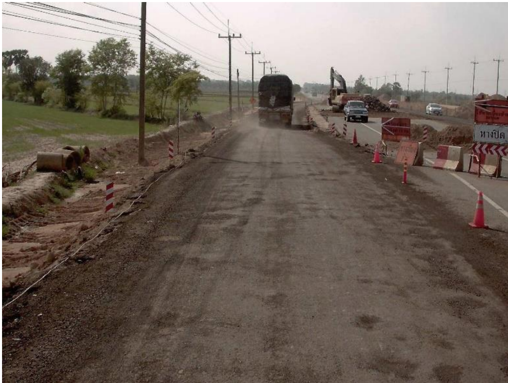
รูปที่ 2-1 อุปสรรคงานก่อสร้างสะพานระหว่างการสำรวจ
