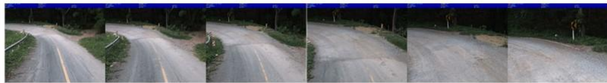
รูปที่ 1-28 เปรียบเทียบค่าความเสียหายที่ STA 3+800 – 3+825
