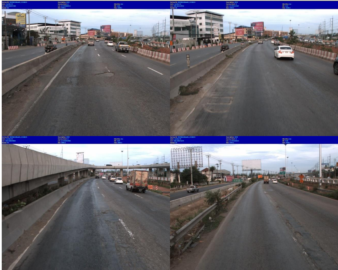
รูปที่ 1-182 ข้อมูลการสำรวจค่าความเสียหาย จากระบบสารสนเทศโครงข่ายทางหลวง (Roadnet) (สายทาง 35 ตอนควนคู 201 แสมดำ - สะพานข้ามแม่น้ำท่าจีนฝั่งตะวันตก ระยะทาง 14+660 - 30+275 งบประมาณประจำปี พ.ศ. 2562)
