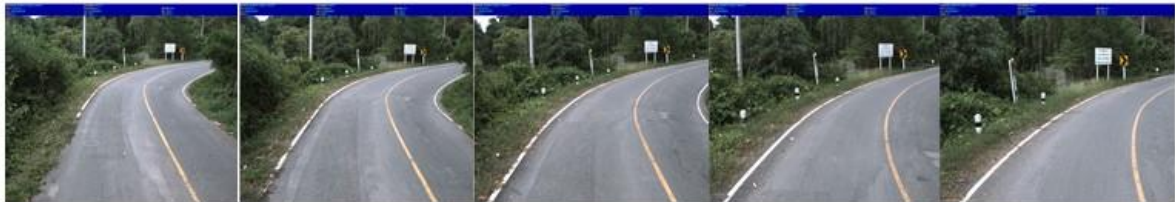
รูปที่ 1-24 เปรียบเทียบค่าความเสียหายที่ STA 2+425 – 2+450
