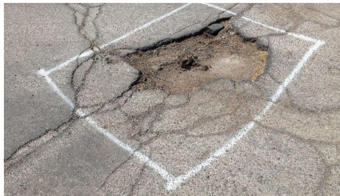
รูปที่ 3-14 หลุมบ่อ
