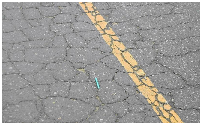
รูปที่ 3-10 รอยแตกต่อเนื่อง (Interconnecting Crack)
