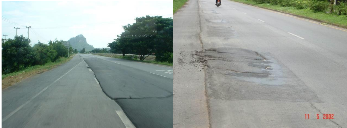
รูปที่ 3-15 รอยปะซ่อม
