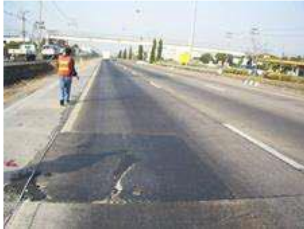
รูปที่ 3-22 รอยปะซ่อม (Patching)
