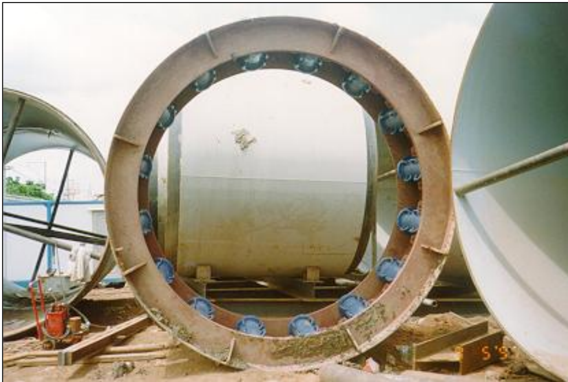
รูปที่ 6.2.1-9 ลักษณะแม่แรงเสริม (Intermediate Jacks)
