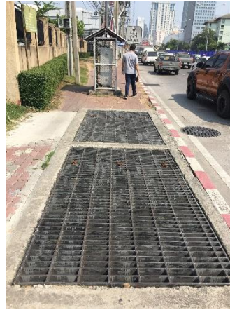
บ่อสูบแจ้งวัฒนะ-บางพูด (เทศบาลนครปากเกร็ด)
