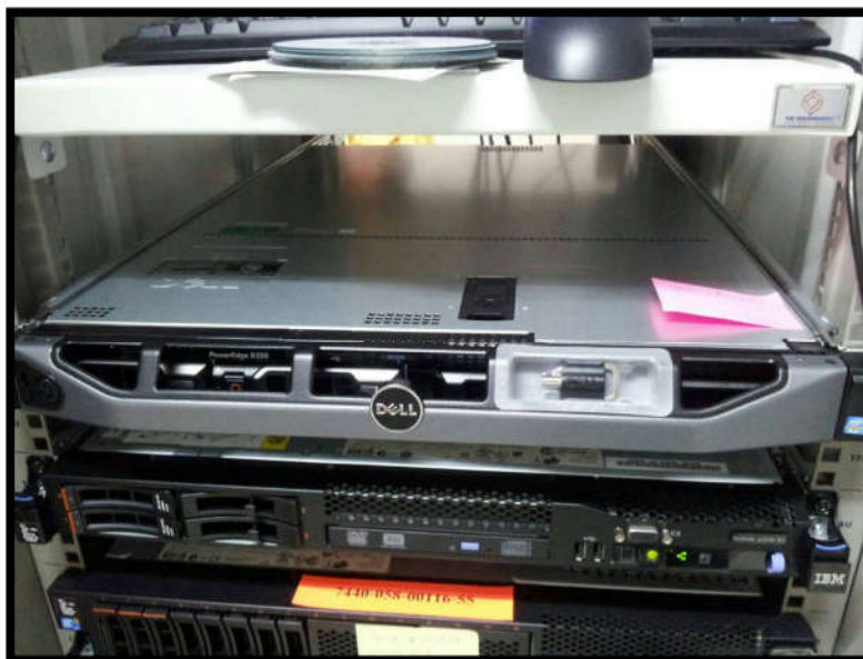
รูปที่ 97 ภาพการติดตั้งเครื่องคอมพิวเตอร์แม่ข่าย
