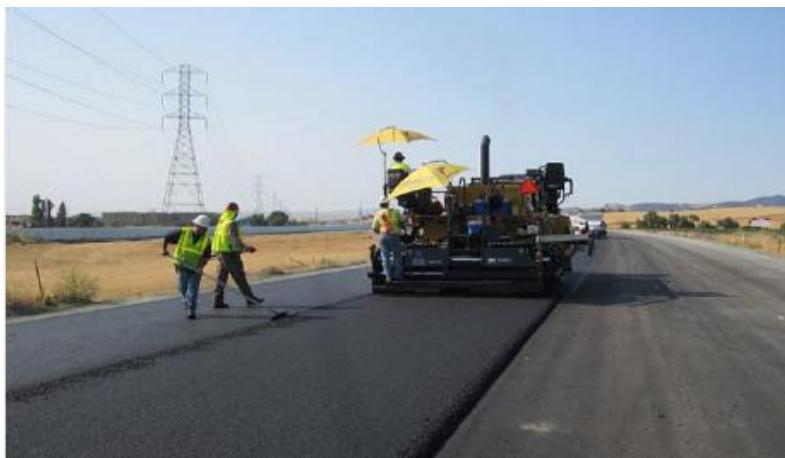
รูปที่ 3-17 งานเสริมผิวลาดยางแอสฟัลต์ติกคอนกรีต
