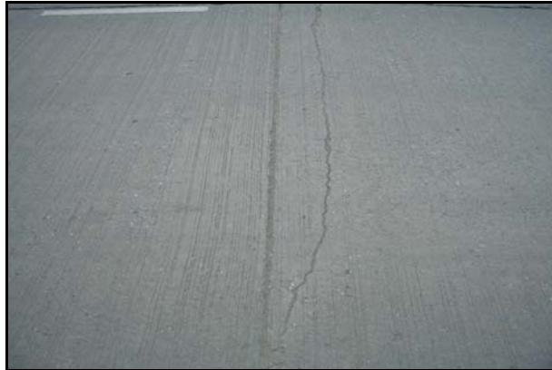
รูปความเสียหายของระบบถ่ายน้ำหนักบริเวณรอยต่อ
